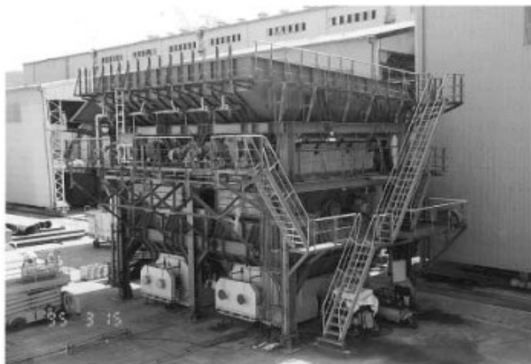
浚渫土処理装置
