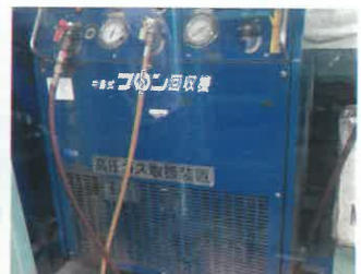
フロンガスの回収装置です。
