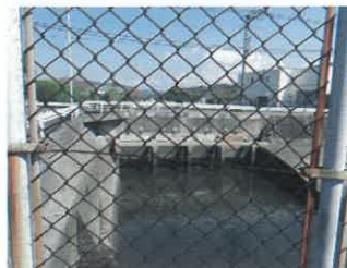
有機水銀廃液を流していた百間排水口の遺構を見学しました。
