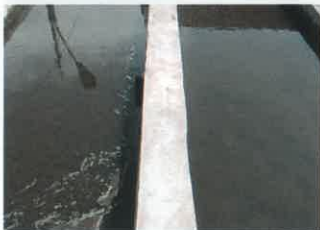
左がフロック形成池、右が沈澱池の状況です。
