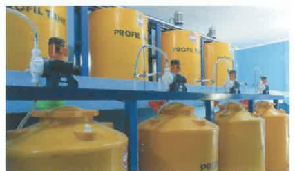
薬剤調製室が整備されましたが、公共事業局からの移管がまだのため使用されていません。
