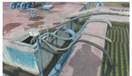
砂ろ過ができないのでバイパスして浄水池にろ過していない水を移送しています。
