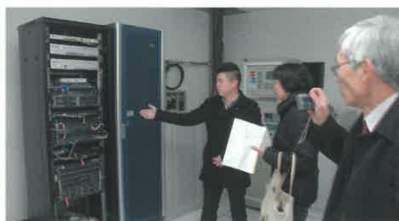
新設された環境モニターングデータ処理室を見学しました。
